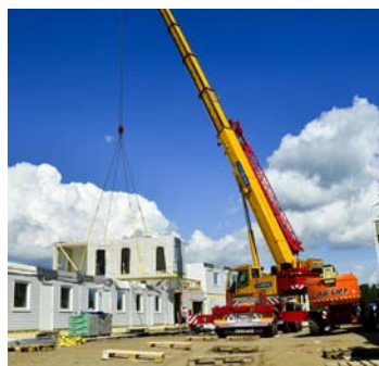
KREFTER: Det skal solide kraner til for å løfte modulene på plass.
